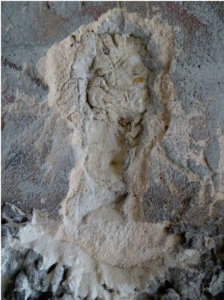
fot. 10: odkrywka wypraw zachodniej ściany przejścia bramnego na styku z opracowaniem cementową zaprawą z grysem kamiennym
