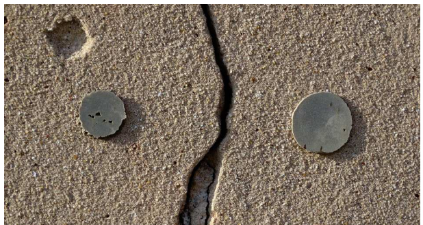
fot. 17: ślad po jednym z niezachowanych szkielek kontrolnych w miejscach pęknięć murów
