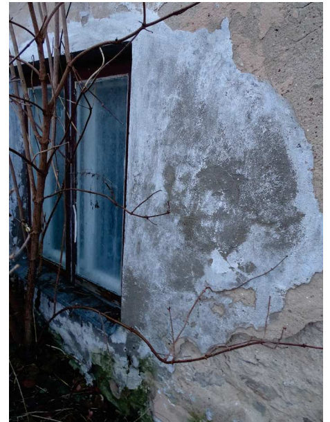
fot. 27: wtórnie obrobiony otwór okienny w parterze elewacji wschodniej; widoczne tynki cementowe i odbiegająca od historycznej stolarka okienna
