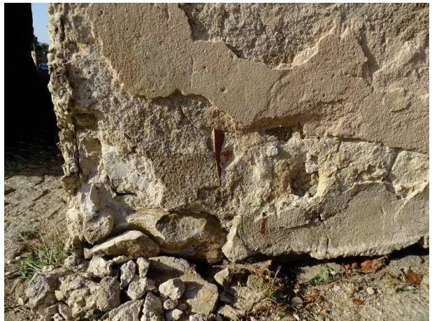
fot. 15: odslonięty fragment muru u podstawy prawej strony łuku bramy na elewacji południowej; widoczne wtórne przemurowanie z wykorzystaniem fragmentów cegieł obok kamienia
