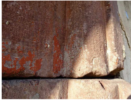
fot. 23: fragment z miejsca oparcia nadproża wschodniego z portali; widoczne przemalowania czerwoną farbą zacierek cementowych zachodzących na lico kamienia przy spoinach, spoiny ponownie uległy w części destrukcji, tu pozostają puste
