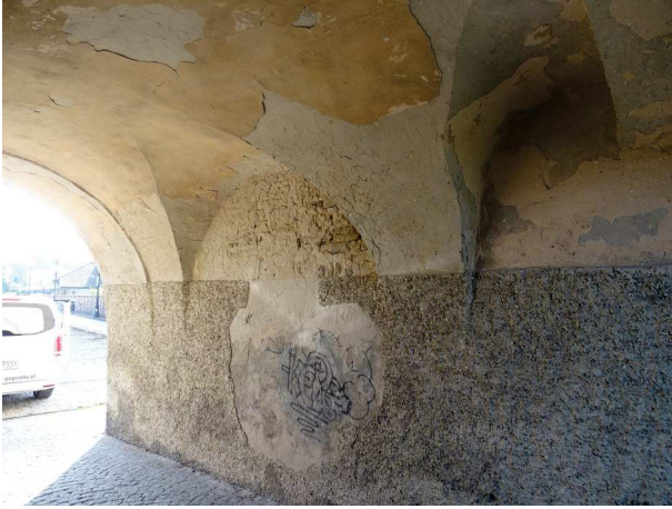
fot. 8: wschodnia ściana i część sklepienia w przejściu bramnym; widoczna głęboka destrukcja kolejnych warstw tynkarskich, w strefie tarczy podsklepiennej widoczne zniszczenia powstałe w wyniku działania wody przesączającej się z piętra
