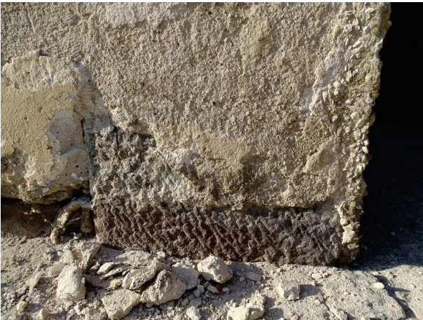
fot. 14: odslonięty cios piaskowcowy u podstawy lewej strony łuku bramy na elewacji południowej; widoczna powierzchnia z wyraźną obróbką kamieniarską
