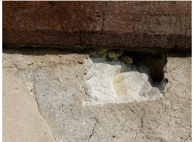
fot. 13: jedna z odkrywek w zamurowanym oknie elewacji zachodniej; widoczna tylko najmłodsza z całościowych wypraw oraz materiał ceglany obok kamiennego w murze
