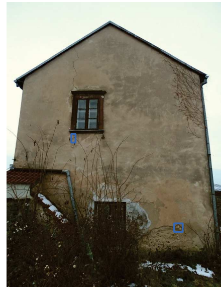
fot. 4: elewacja wschodnia z zaznaczeniem: □ - wykonanych odkrywek konserwatorskich, ● - pobranych do badań próbek
